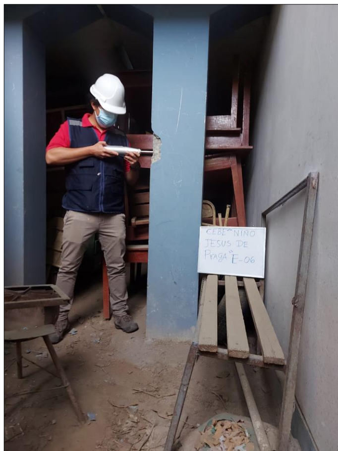
Vista fotográfica de realización del ensayo de esclerometría en el módulo I.
