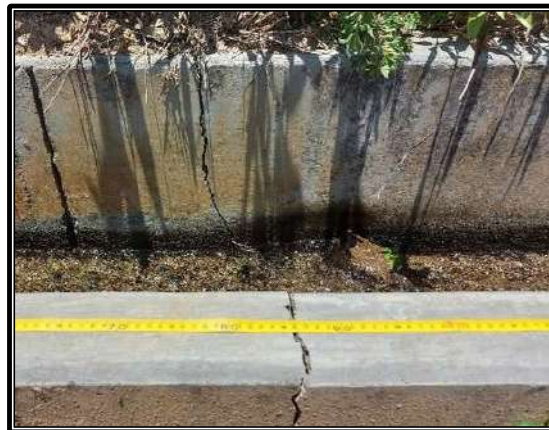
Nota: Se verifica las grietas por el mal adecuado diseño de juntas en el canal riego Canchan Lindero – Tomaykichwa, Provincia de Ambo.
