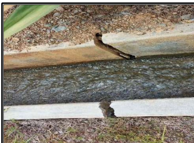
Nota: Se observa el deterioro de la junta de dos tramos, el cual se recomienda el uso de juntas con WaterStop en el canal riego Canchan Lindero.
