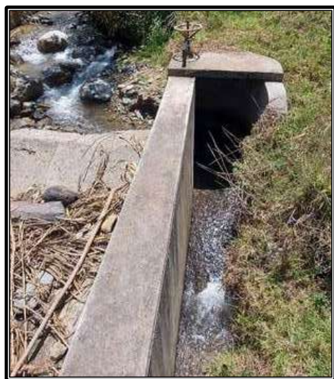
Nota: Se observa el canal derivador Canchan Lindero – Tomaykichwa, Provincia de Ambo.
