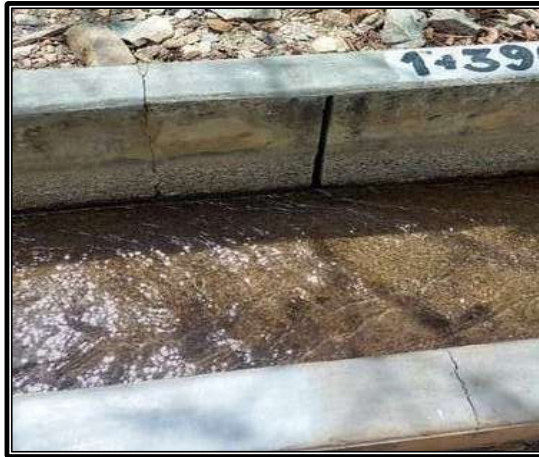
Nota: Se verifica las grietas por el mal adecuado diseño de juntas en el canal riego Canchan Lindero – Tomaykichwa, Provincia de Ambo.
