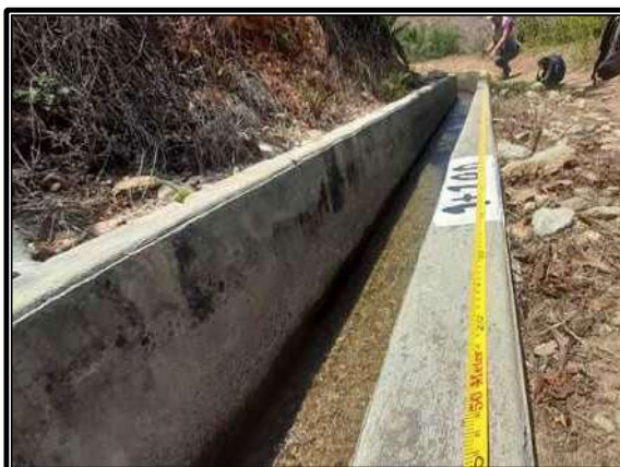
Nota: Se hace la medición de los tramos afectados en el canal riego Canchan Lindero – Tomaykichwa, Provincia de Ambo.
