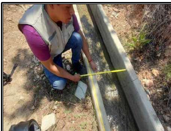
Nota: Se hace la medición de la geometría del tramo afectado en el canal riego Canchan Lindero – Tomaykichwa, Provincia de Ambo.
