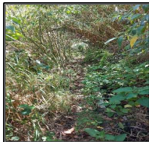
Nota: Se observa en estado del canal en ciertos tramos, el cual se encuentra con maleza y sedimentos del canal Canchan Lindero – Tomaykichwa, Provincia de Ambo.
