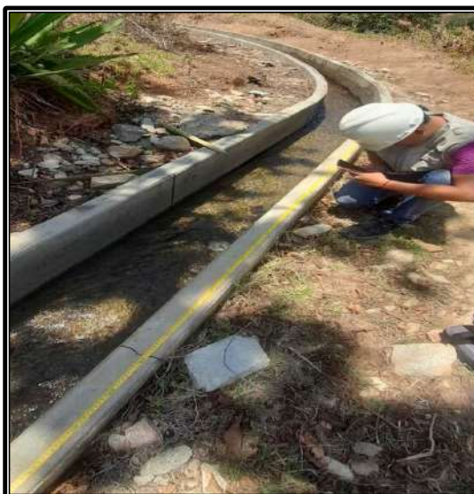
Nota: Se hace la medición de los tramos afectados en el canal riego Canchan Lindero – Tomaykichwa, Provincia de Ambo.
