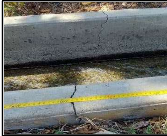
Nota: Se verifica las grietas por el mal adecuado diseño de juntas en el canal riego Canchan Lindero – Tomaykichwa, Provincia de Ambo.
