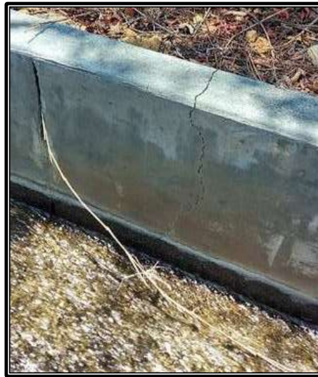
Nota: Se verifica las grietas por el mal adecuado diseño de juntas en el canal riego Canchan Lindero – Tomaykichwa, Provincia de Ambo.
