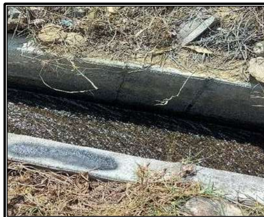
Nota: Se verifica las grietas por el mal adecuado diseño de juntas tramo 2 en el canal riego Canchan Lindero – Tomaykichwa, Provincia de Ambo.
