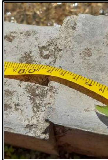
Nota: Se verifica el hundimiento de un tramo debió a las filtraciones por mal diseño de juntas el canal riego Canchan Lindero – Tomaykichwa, Provincia de Ambo.
