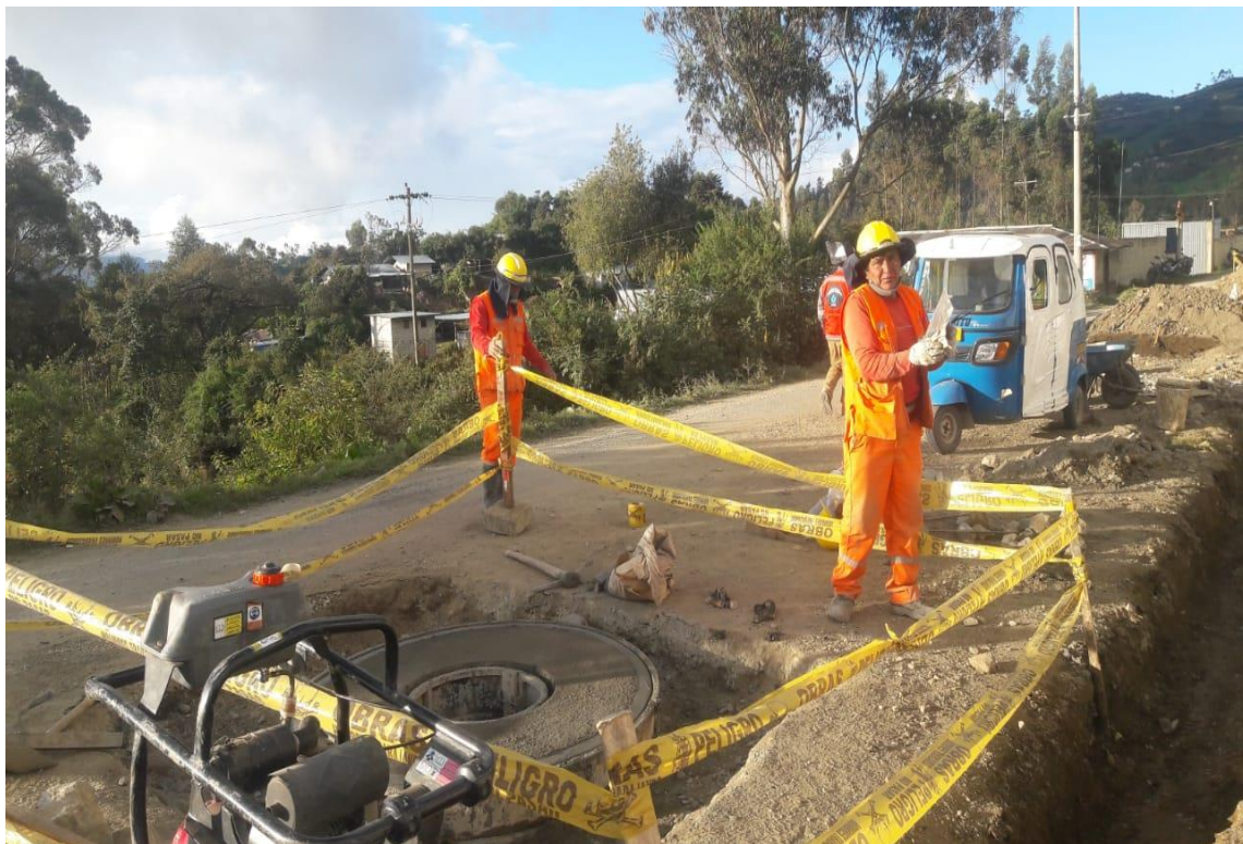
En la vista fotográfica se observa los trabajos de concreto armado en la red colector como es los buzones por el personal calificado.
