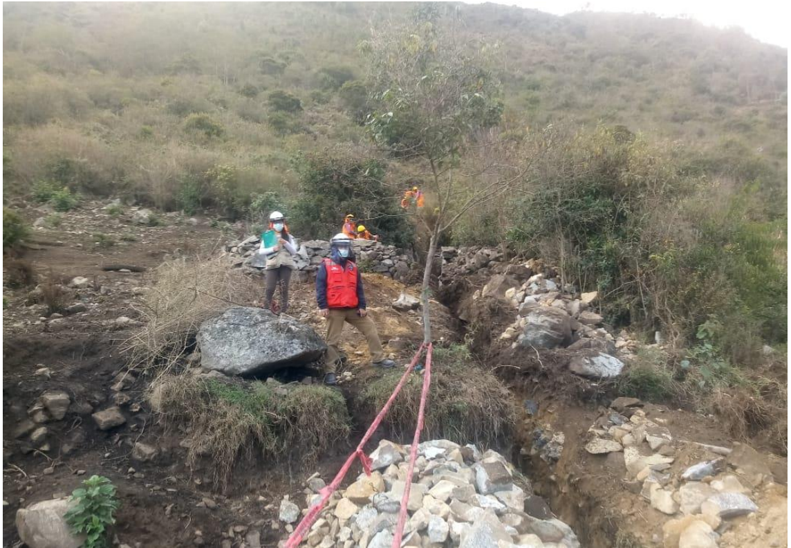
En la vista fotográfica se observa los trabajos de excavación de la red colector hacia la planta de tratamiento PTAR
