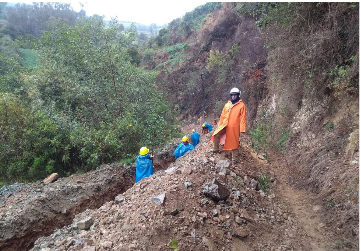
En la vista fotográfica se observa la verificación de los trabajos de la línea de conducción como es la excavación de zanjas para tubería.
