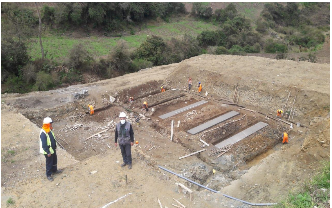
Otra vis vista fotográfica donde se observa la instalación para la planta de tratamiento de las aguas residuales
