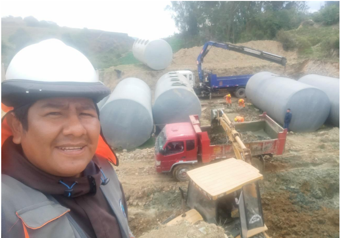
En la vista fotográfica se observa el suministro e instalación de los cisternas para la planta de tratamiento de las aguas residuales
