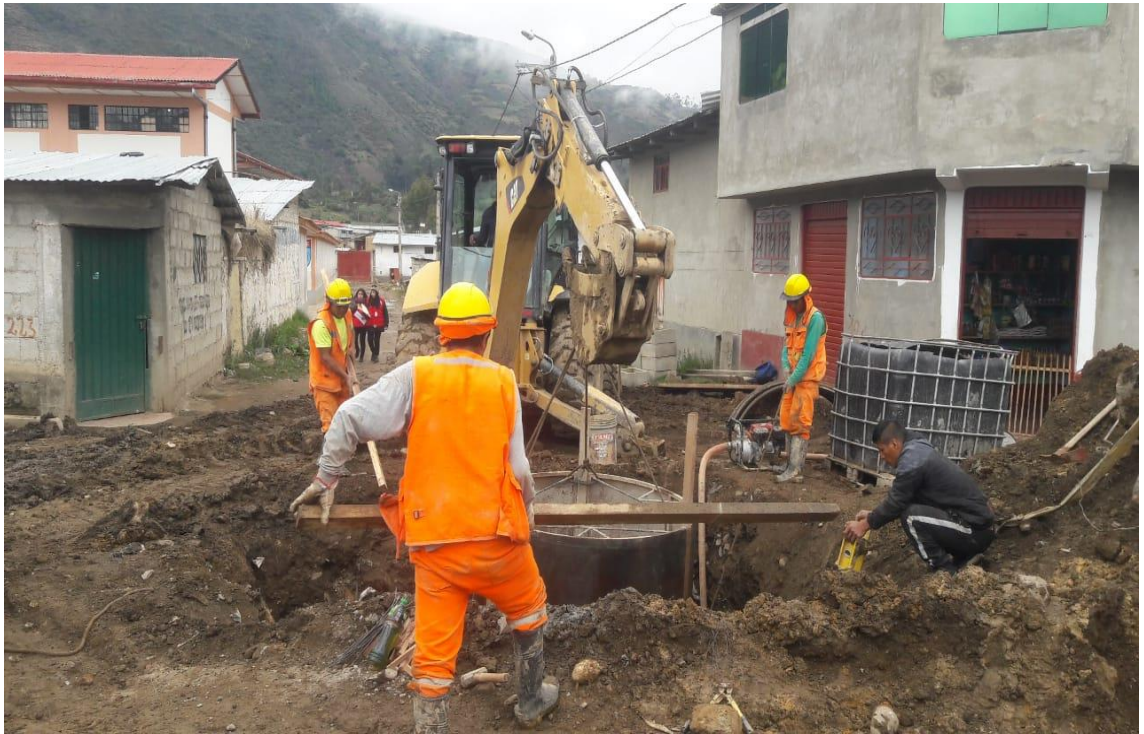
En la vista fotográfica se observa los trabajos de encofrado a través de moldes con apoyo de maquinaria, se observa mano de obra y maquinarias
