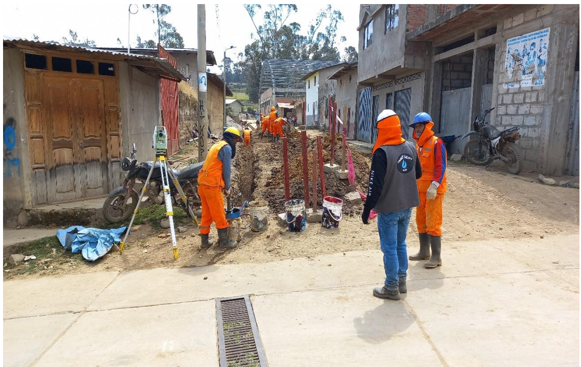
En la vista fotográfica se observa Trazo y Replanteo de la red de distribución además de los trabajos de movimiento de tierra por el personal obrero.
