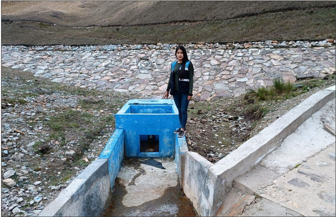
CAJA DE VÁLVULAS DEL REPRESAMIENTO DE LAGUNA.
