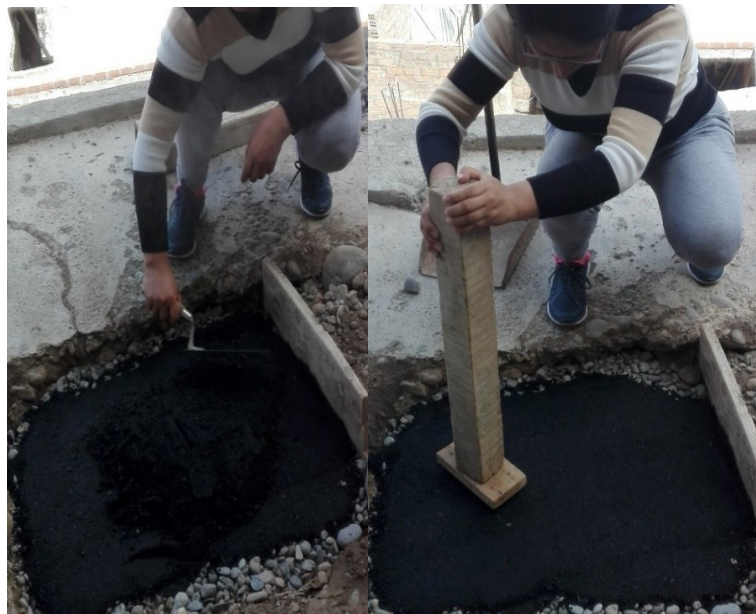
Esparcido de la mezcla con badilejo y compactación de la carpeta asfáltica.
