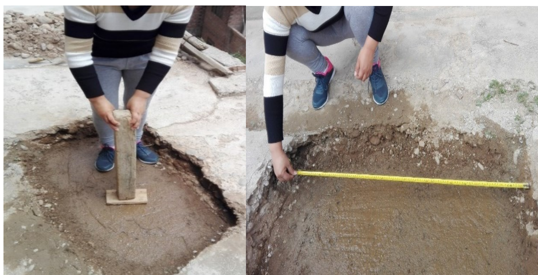
Compactación de base con apisonador artesanal y medición de área para prototipos
