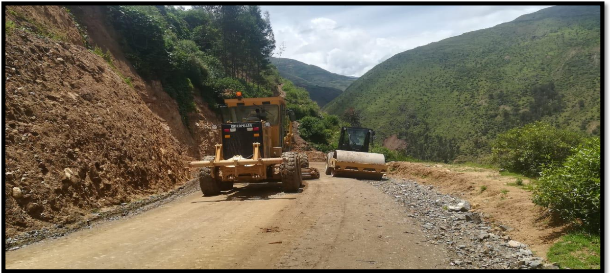
Se tiene el compactado del afirmado en la vis en el tramo II, Huillaparac.
