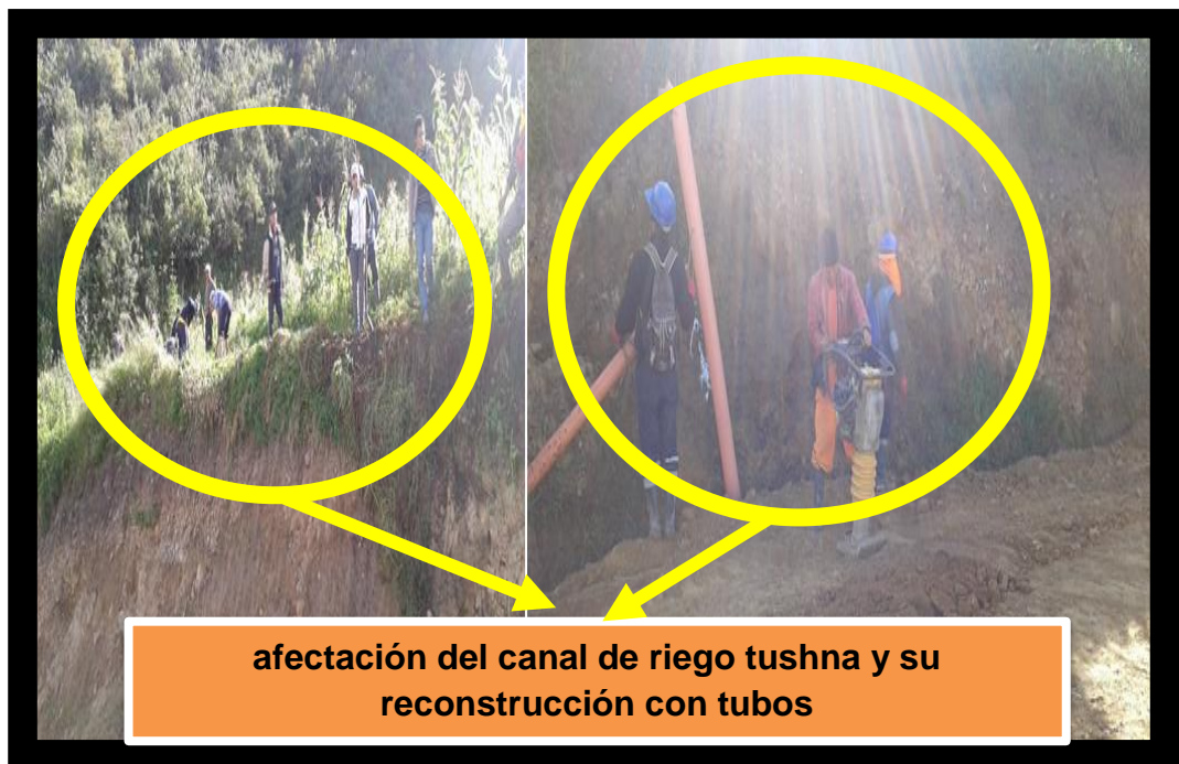
Imagen N°017. Afectación al canal de riego tushna En la imagen se observa la puesta de tubo para remediar la clausura del canal de riego tushna que fue afectado por los cortes de talud.
