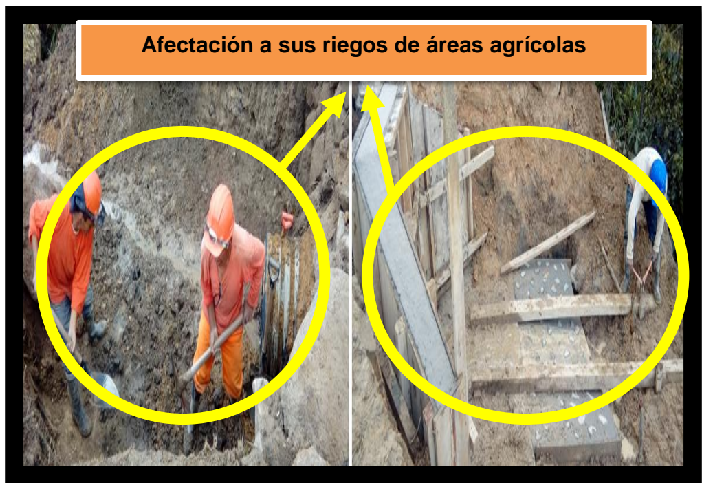
Imagen N°016. Afectación al canal de riego tushna. En la imagen se observa la afectación del canal de riego tushna, el cual origino un problema social con los usuarios.
