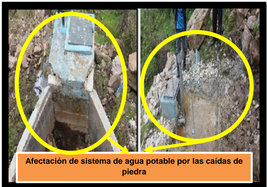
Imagen N°013. Afectación a la propiedad privada. Como se observa se afectado los sistemas de tubería de agua potable por cortes de talud.
