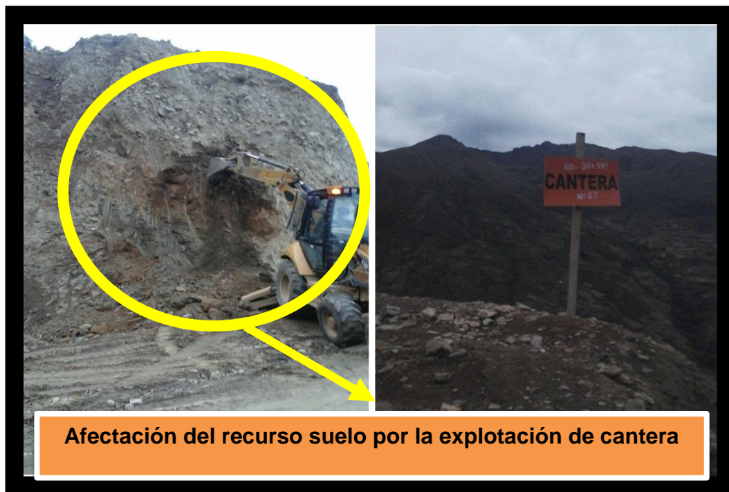
Imagen N° 024: Afectación del recurso suelo por la explotación de cantera. En la imagen se observa la afectación por la explotación de la cantera ubicada en la progresiva. 30+510.
