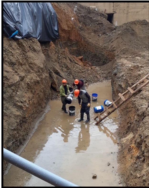
Aparición de aguas freáticas durante la excavación para la subestructura.
