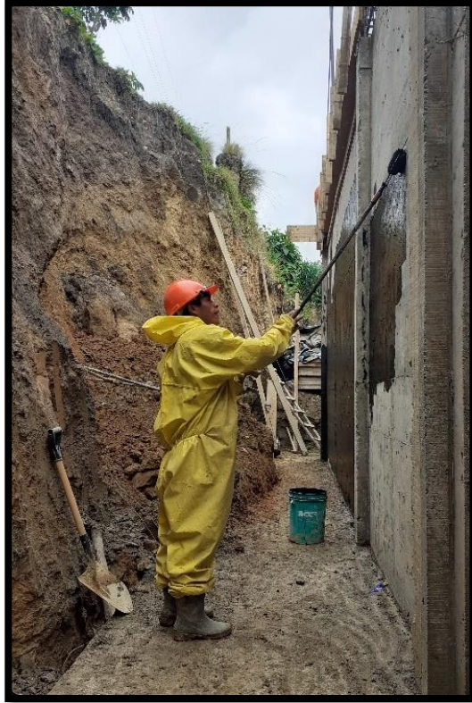
Se observan las filtraciones de agua procedentes del subsuelo.
