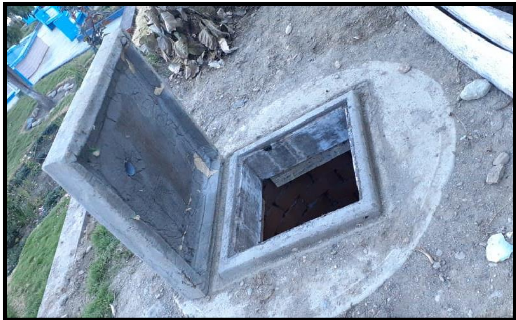
Construcción de pozo de infiltración para absorción de las aguas freáticas provenientes de la subestructura.
