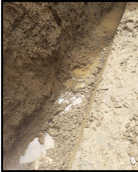
Aparición de aguas freáticas durante la excavación para la subestructura.
