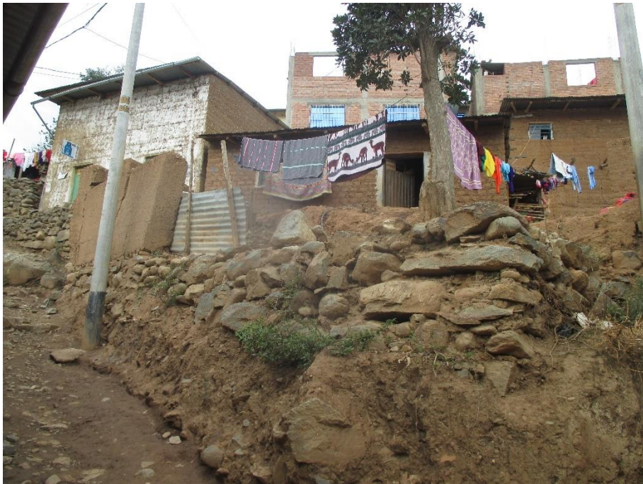
Imagen 6: Estado actual de las viviendas locales. Se observa material predominante Adobe/Tapial. (Febrero – 2020).
