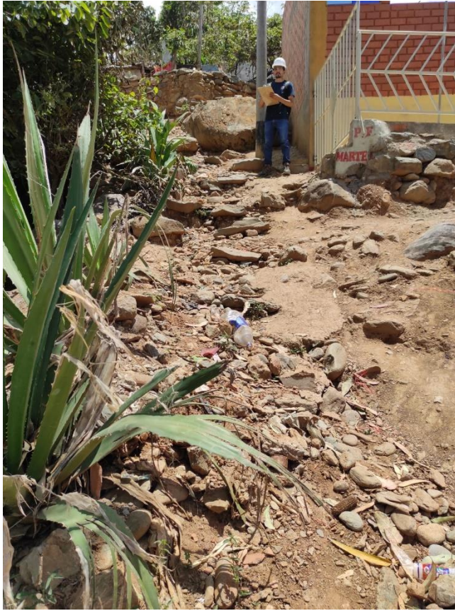
Imagen 8: Se observa material deslizable con dirección a favor de la pendiente. (Febrero – 2020).
