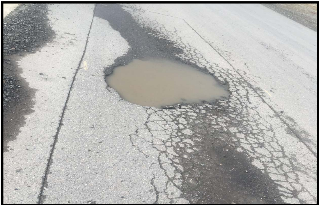
Se observa 3 fallas desprendimiento de agregados, piel de cocodrilo, hueco / baches en la unidad de muestro adicional UM 36.
