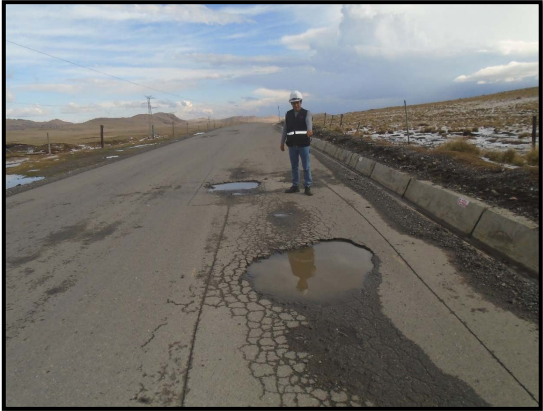
Unidad de muestra UM 143 presenta piel de cocodrilo el cual por ser nivel de severidad alto se generaron grietas de gran tamaño.
