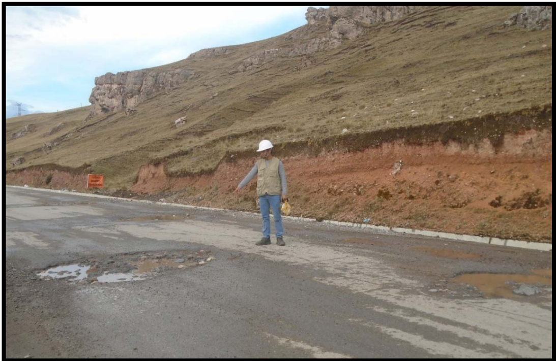
Unidad de muestra UM 133 presenta Fisuras en bloque de alta severidad, se generaron grietas de gran tamaño.
