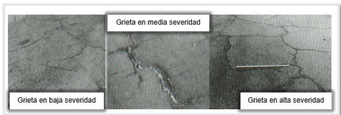
Figura 7. Agrietamiento de acuerdo a la severidad
