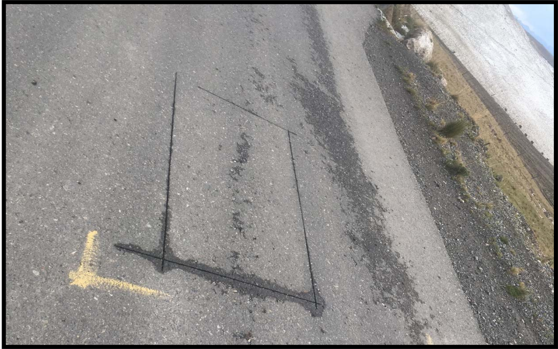
Exudación en un grado bajo en la parte longitudinal del pavimento en la unidad muestral 113.
