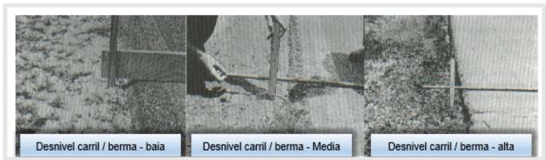
Figura 13. Desnivel carril – Berma por severidad
