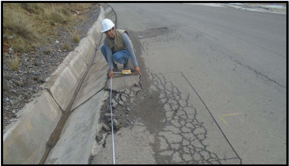
Fisura de borde de alto nivel de severidad. Se localiza en la unidad de muestra UM 103. El pavimento se ha desprendido a lo largo del borde de la pista.
