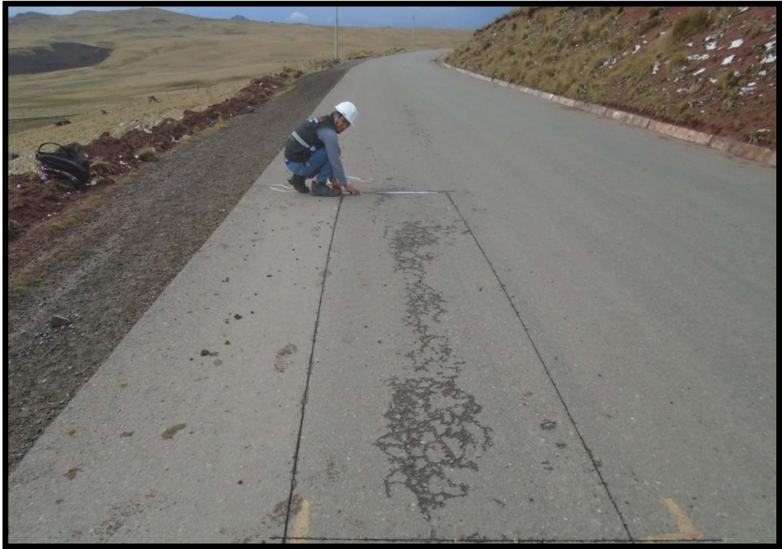
Desarrollo posterior de grietas piel de cocodrilo del nivel M, en un patrón o red de grietas ligeramente descascaradas en la UM 63.
