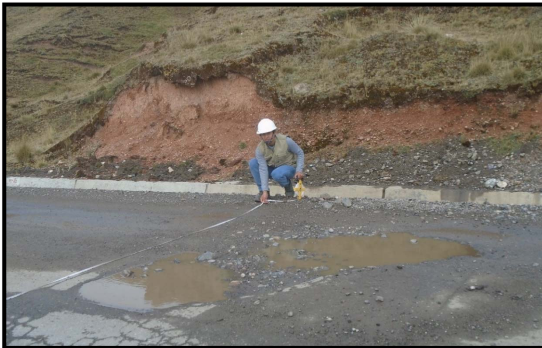
Hueco de alta severidad, ubicado en la unidad de muestra UM 123.
