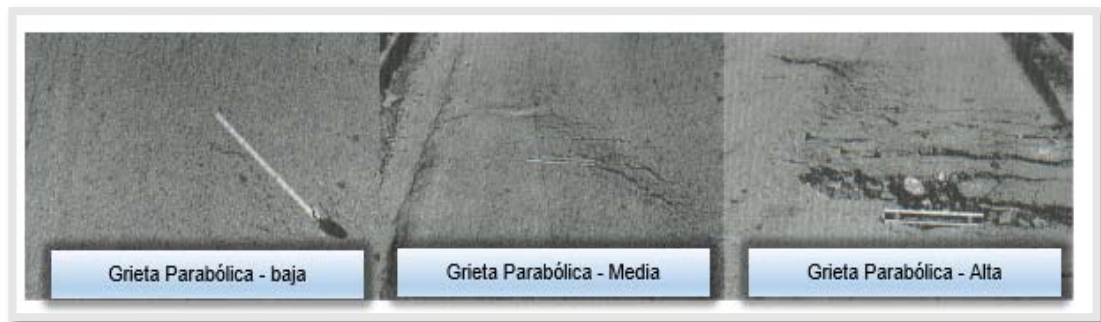
Figura 20. Grietas Parabólicas según severidad
