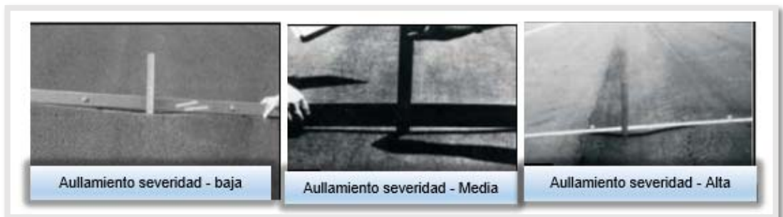
Figura 18. Ahuellamiento por severidad
