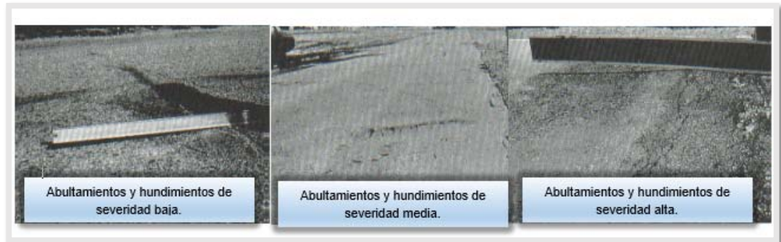
Figura 8. Abultamientos y hundimientos de acuerdo a la severidad.
