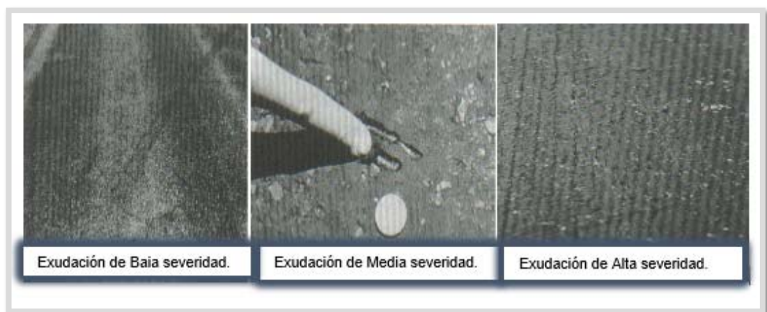
Figura 6. Exudación de acuerdo a la severidad
