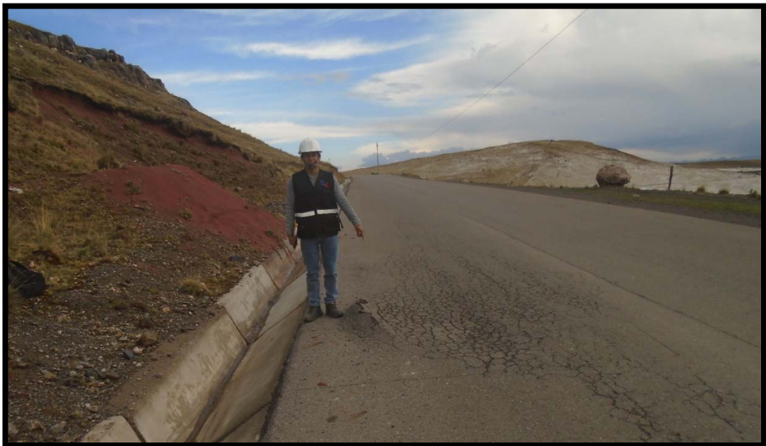
Abultamiento de alta severidad en la unidad de muestra UM 63, originado por las cargas vehiculares que han ido deformando el pavimento.
