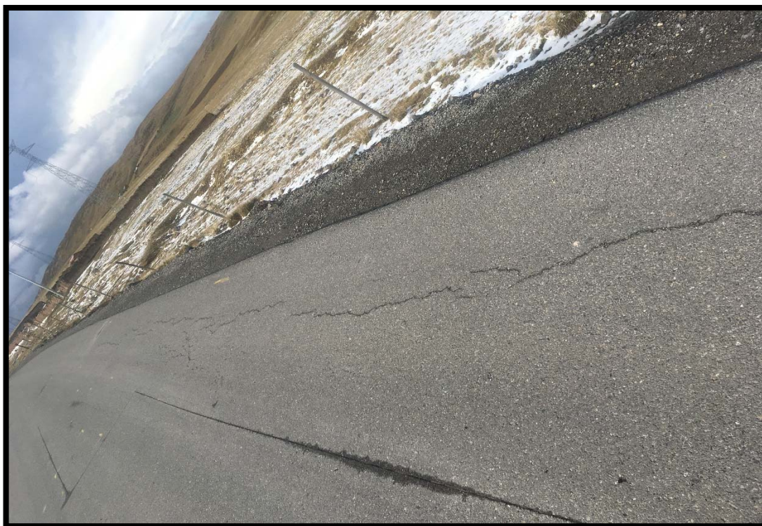
Gritas longitudinales de baja severidad encontradas en la unidad muestral 143.
