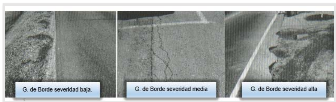
Figura 11. Grieta de borde por severidad
