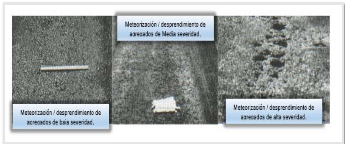
Figura 22. Meteorización y desprendimiento por severidad
