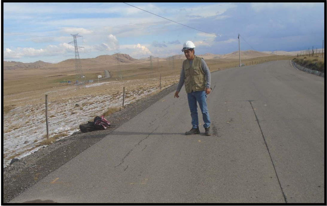
Grietas longitudinales en la unidad de muestra 63 progresiva 1+953,00 a 1+984,50.
