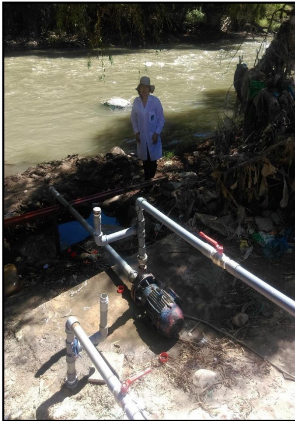
Imagen 12: Punto de ubicación de donde se bombea el agua para tratar.
