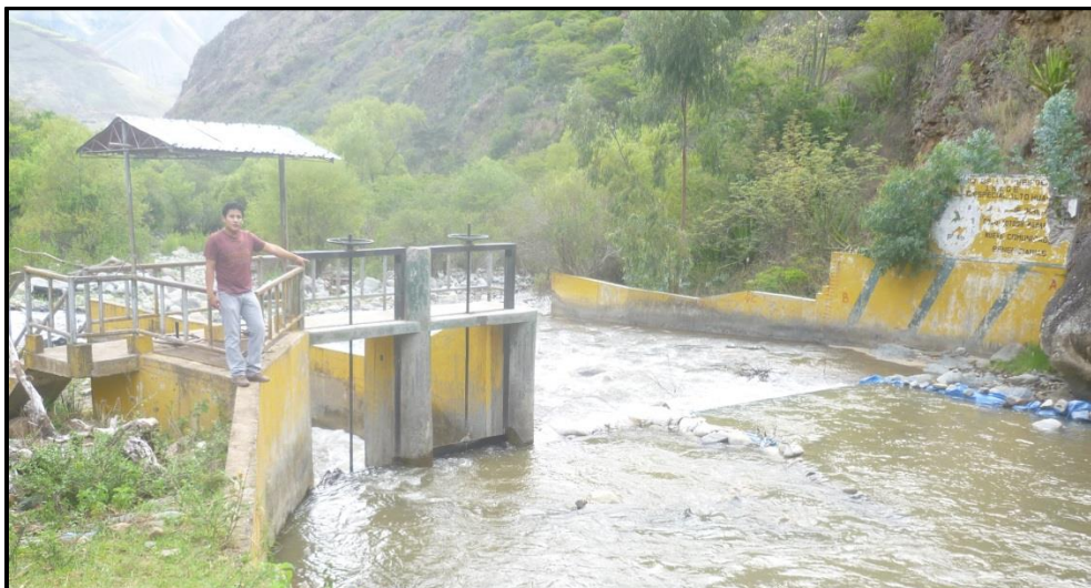
Fotografía N°03: Captación de las aguas del rio Cozo.
