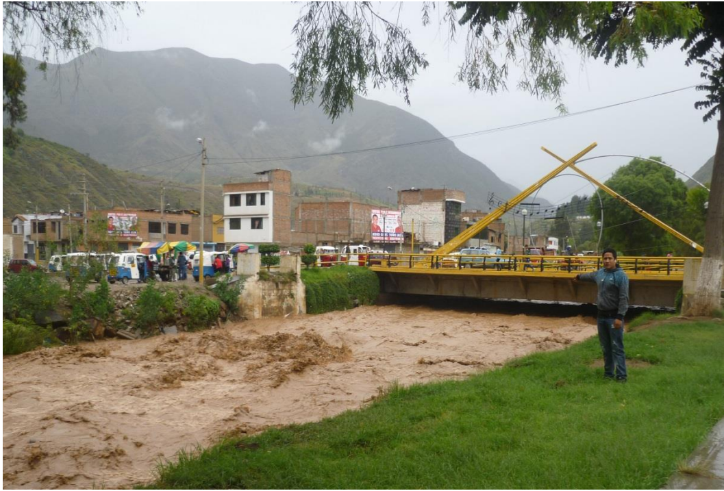
Fotografía N°28: Puente León de Huánuco vulnerable frente a las crecidas del caudal del río Higueras.
