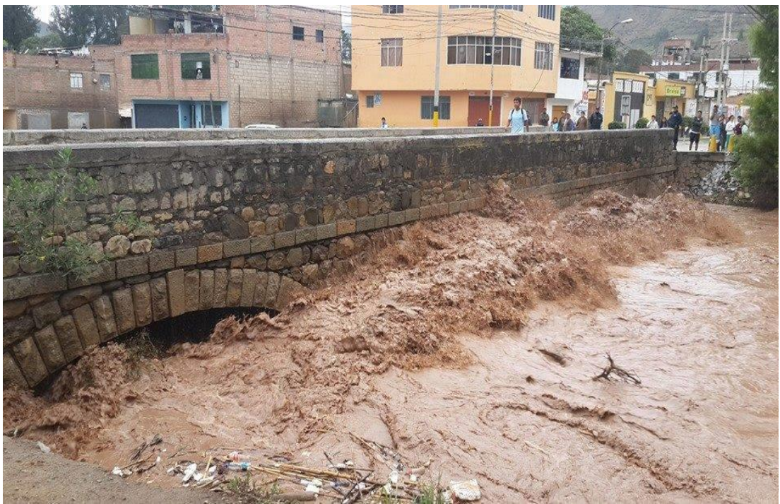
Fotografía N°26: Puente Tingo erosionado por la crecida de caudal del rio Higueras.
