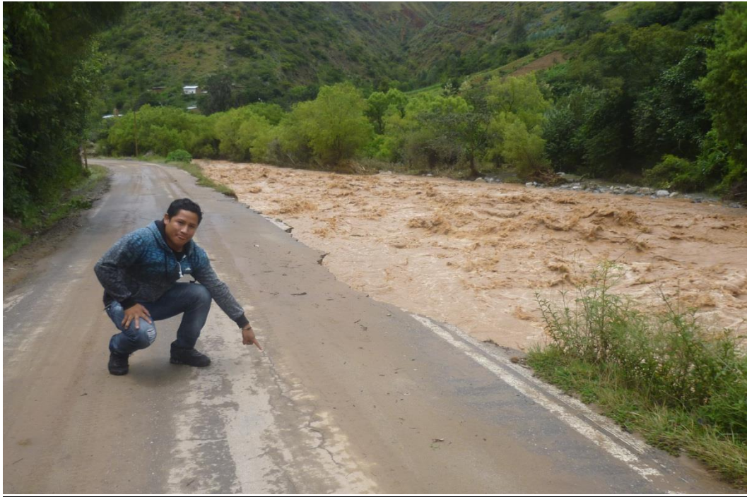
Fotografía N°30: Colapso de calzada y formación de fisuras en la carretera Huánuco – La Unión, generada por la crecida de caudal del río Higueras.
