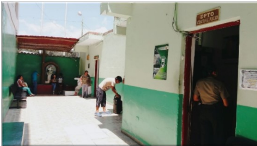
FOTO N°14: Espacio de espera de usuarios, sin techo a expensas del sol y la lluvia.
