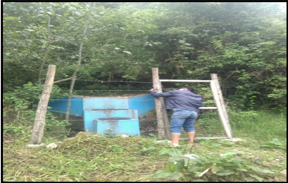
Fotografía 01: captación del sistema
