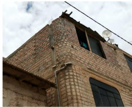
Conexión al ras inadecuada.
