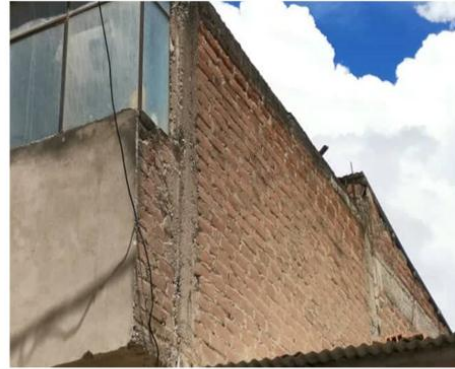
Juntas inadecuadas en el muro portante.
