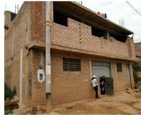
Vanos no continuos en elevación.
