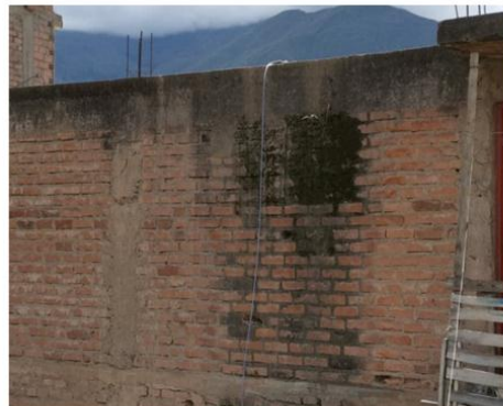
Muro portante con humedad.
