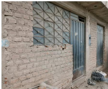
Vanos con longitud menor a (L \text{ muro}/2) , alféizares no aislados.
