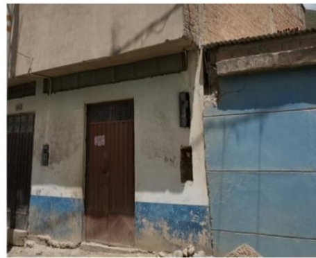
Falta de junta sísmica entre viviendas.
