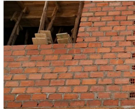
Junta con espesor inadecuadas.
