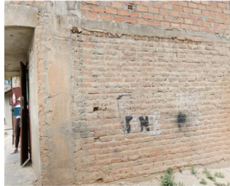
Juntas inadecuadas en el muro portante.
