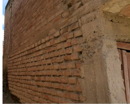
Juntas inadecuadas en el muro portante.
