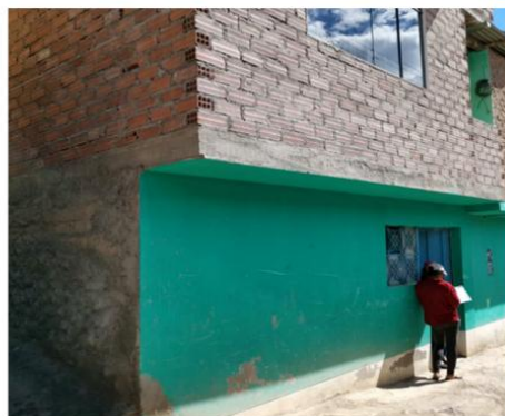
Vanos con longitud mayor a (L \text{ muro}/2) .
