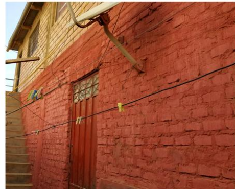
Junta con espesor inadecuadas.
