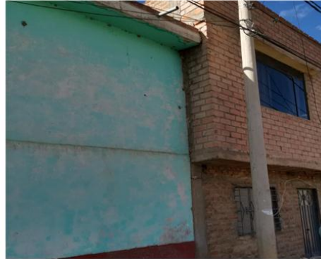
Losas a desnivel con la vivienda adyacente.
