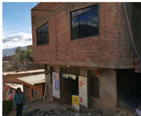
Vanos no continuos en elevación.
