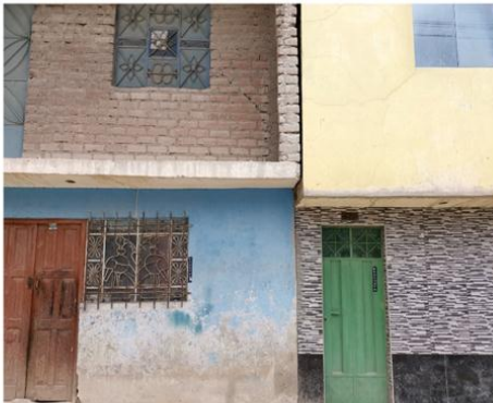
Losas a desnivel entres viviendas y falta de junta sísmica.
