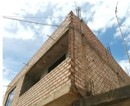
Muros portante con ladrillo pandereta.
