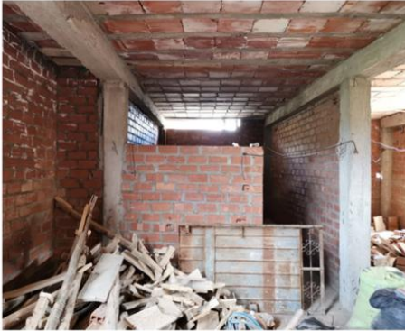
Alféizar no aislado, falla por columna corta.
