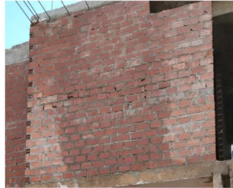
Uso de ladrillo pandereta en muro portante.
