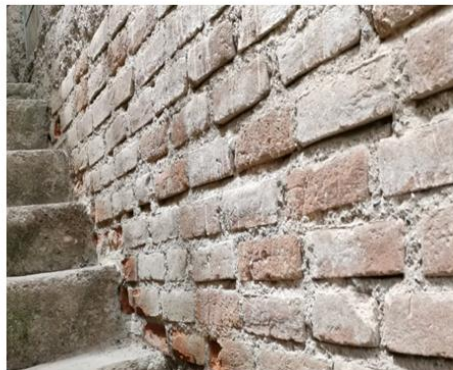
Juntas inadecuados y contenido de humedad en el muro portante.
