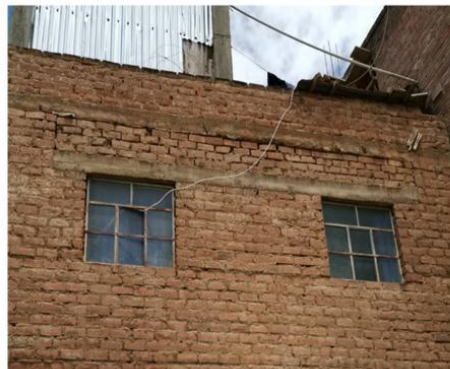
Inadecuada conexión techo - muro.
