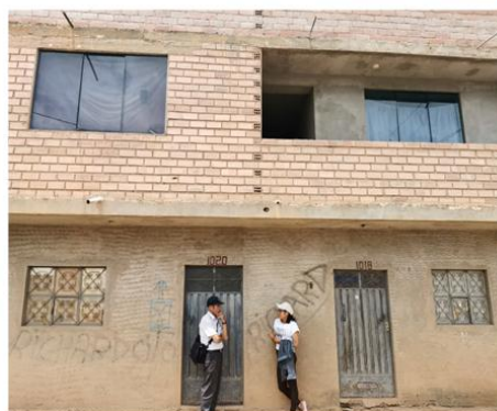
Vanos no continuos en elevación.
