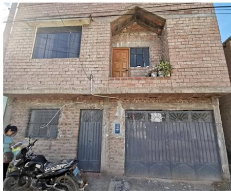
Vanos no continuos en elevación.
