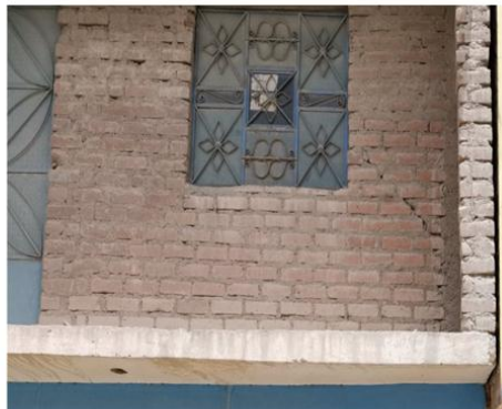
Alféizar no aislado, muro agrietado.
