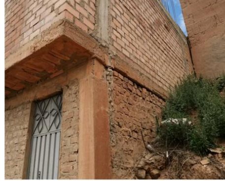
Espesor de juntas inadecuadas.
