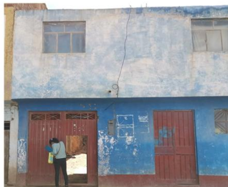
Vanos no continuos en elevación.
