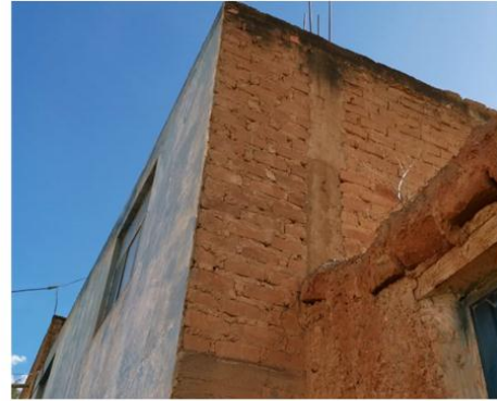
Espesor de juntas inadecuadas.
