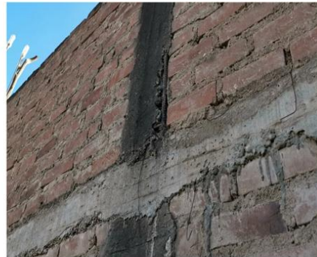
Aceros de refuerzo expuestos.
