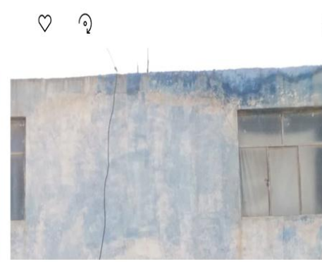
Contenido de humedad en los muros.
