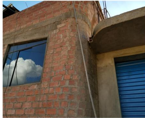
Losas a desnivel con la vivienda adyacente.
