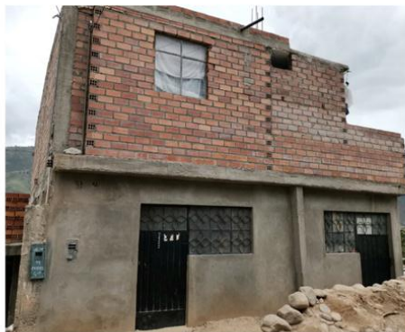
Vanos no continuos en elevación.
