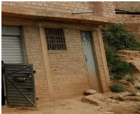
Alféizar no aislado, falla por columna corta.
