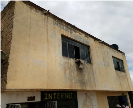
Alféizares no aislados, contenido de humedad.
