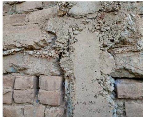
Cangreja en la columna y aceros expuestos.
