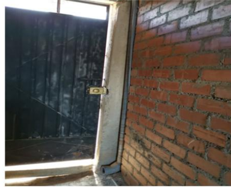
Tubería de desagüe dentro del muro portante.
