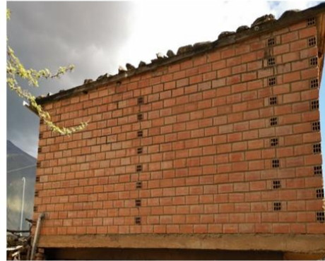
Uso de ladrillo pandereta en los muros portantes.
