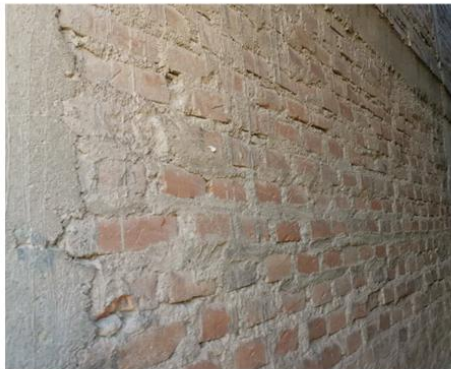
Juntas inadecuadas en el muro portante.
