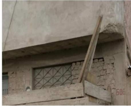
Inadecuada conexión de techo - muro.
