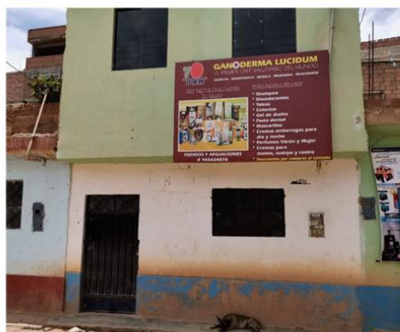
Vanos no continuos en elevación.
