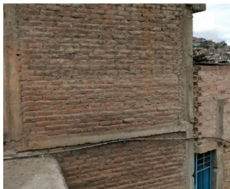
No presenta junta sísmica entre viviendas y losas a desnivel.
