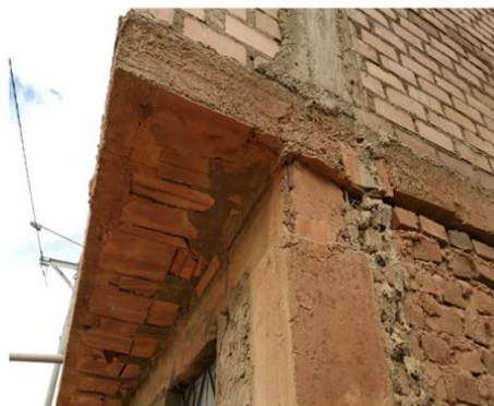
Aceros de refuerzo expuestos y columnas no continuas
