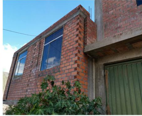
Losas a desnivel con la vivienda adyacente.
