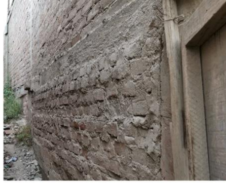
Espesor de juntas inadecuadas.
