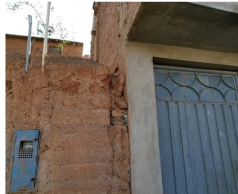
Falta de junta sísmica entre viviendas.
