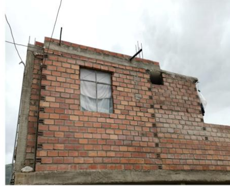
Uso de ladrillo pandereta en muros portantes.
