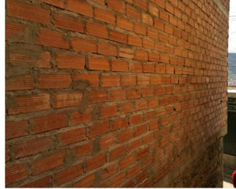
Espesor de juntas inadecuadas.
