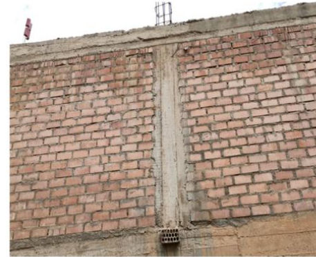
Conexión dentada inadecuada.
