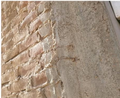
Juntas inadecuadas en el muro portante.
