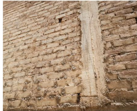
Juntas inadecuadas en el muro.
