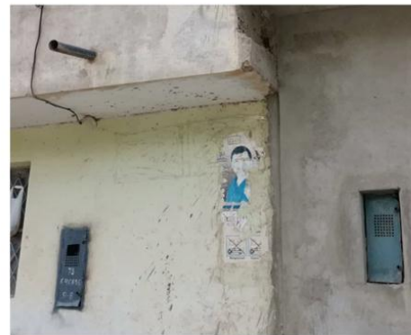
Falta de junta sísmica entre viviendas.
