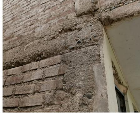
Aceros de refuerzos expuestos en viga.
