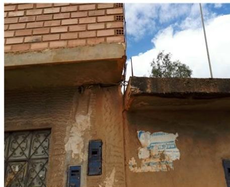
No presenta junta sísmica y losas a diferente niveles
