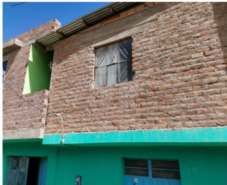
Losas a desnivel entres viviendas.
