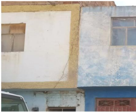
No cuenta con junta sísmica entre viviendas.
