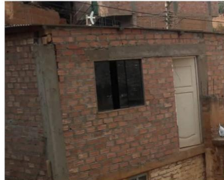
Inadecuada conexión columna - muro.
