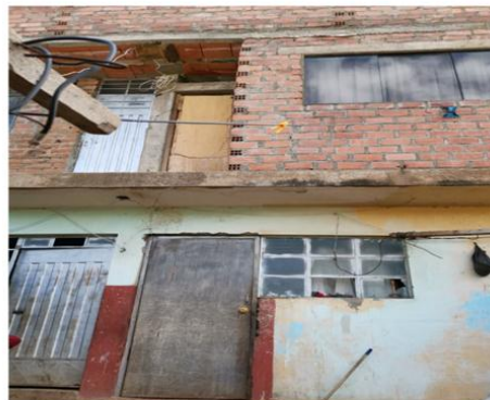
Vanos no continuos en elevación.
