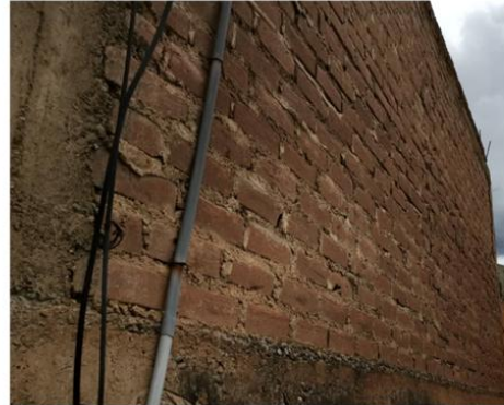
Juntas inadecuadas en el muro.
