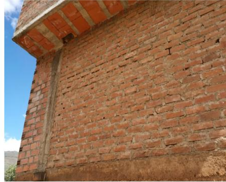
Juntas inadecuadas en los muros portantes.
