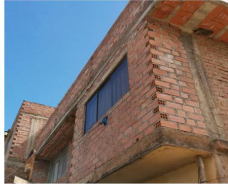
Uso de ladrillo pandereta en muros portantes.
