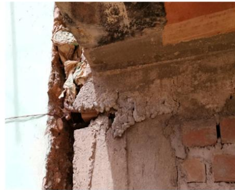
Aceros de refuerzos expuestos en viga.
