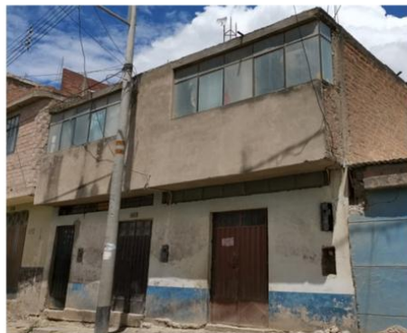
Vanos no continuos en elevación, alféizares no aislados.
