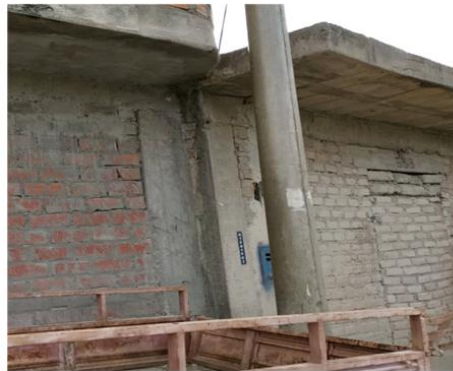
Falta de junta sísmica entre viviendas.
