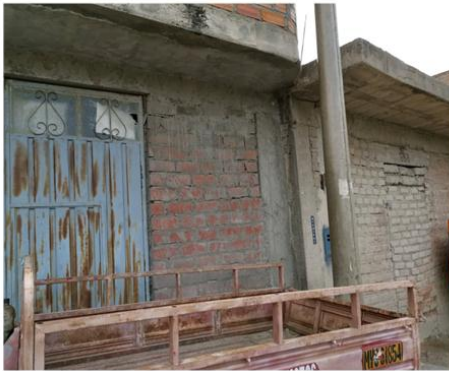
Losas a desnivel entres viviendas.
