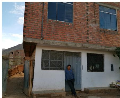
Vanos no continuos en elevación.
