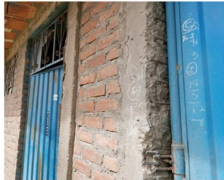
Aceros de refuerzos expuestos en columna.
