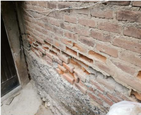
Deterioro de los ladrillos del muro portante.
