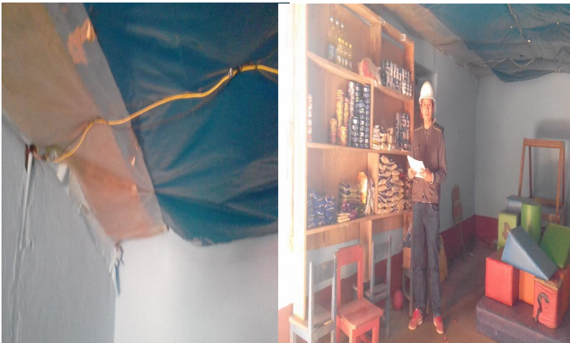
Fotografía 10. Podemos observar en el ambiente mencionado la incorrecta instalación de los cables de energía eléctrica que es muy peligrosa para dicho ambiente ya que se encuentra muy vulnerable.
