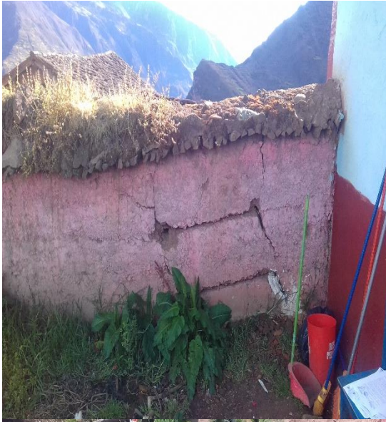
Fotografía 13. En la fotografía podemos apreciar el cerco perimétrico que colinda con la cocina en mal estado con grietas y fisuras, exponiendo a la cocina cuando colapse.
