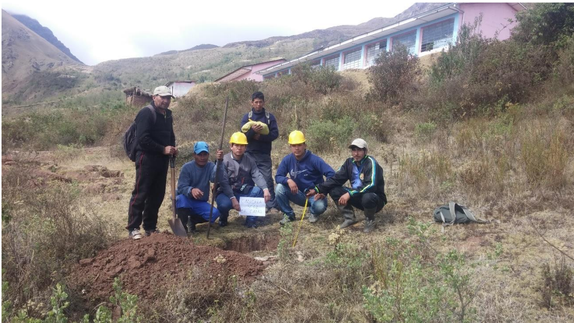
Fotografía 4. En la fotografía podemos apreciar la excavación de la calicata N°2 y procedemos a la toma de muestras.
