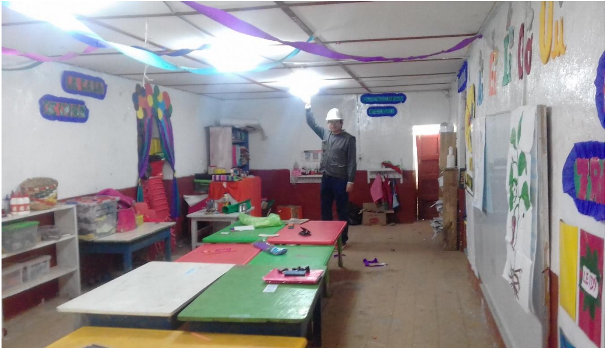
Fotografía 17. En dicho ambiente se aprecia la escasez de luz natural, conllevándonos a hacer uso de la luz artificial que no es muy recomendado para los niños. Esto es debido a las reducidas áreas de las ventanas que también impide una ventilación adecuada para el ambiente.
