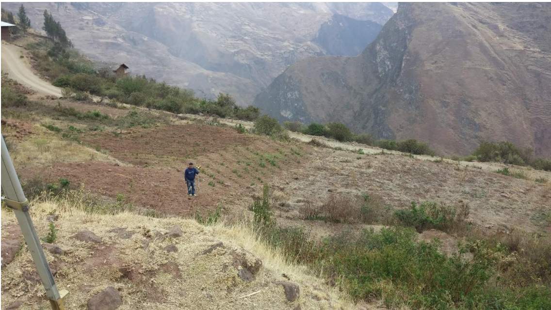
Fotografía 2. Apreciamos el inicio del levantamiento topográfico, comenzando con el primer punto la cual viene a ser nuestro BM-01.
