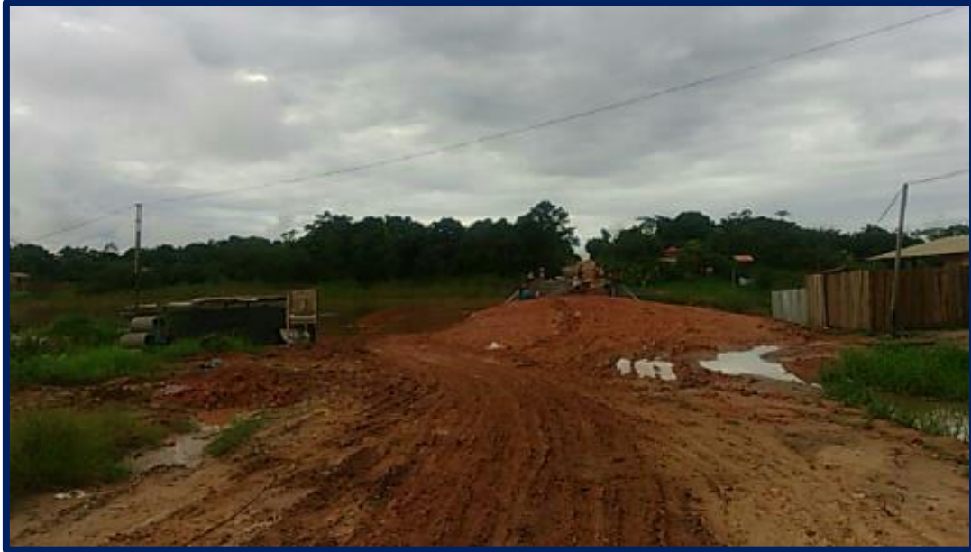
FOTO 09: SE OBSERVA EL MAL ESTADO DE LA VIA EN EPOCAS DE LLUVIA, FALTA ADECUADO SISTEMA DE DRENAJE PLUVIAL – PROGRESIVA 00+600.00
