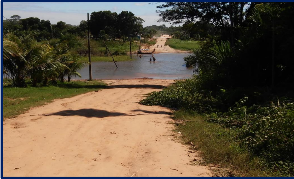
FOTO 07: TRAMO INUNDABLE, SE OBSERVA QUE LA CRECIENTE QUE SE DA EN EPOCAS DE INVIERNO EL NIVEL DE AGUA SOBREPASA EL PUENTE EXISTENTE, DEJANDO AISLADO A LA POBLACION DEL CASERIO SAN JUAN ENTRE OTROS (C. SANTA ROSA) – PROGRESIVA 00+406.00
