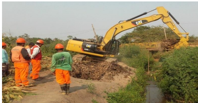
Fig. 4.2.4. Imagen de los equipos utilizados y el personal calificado.
