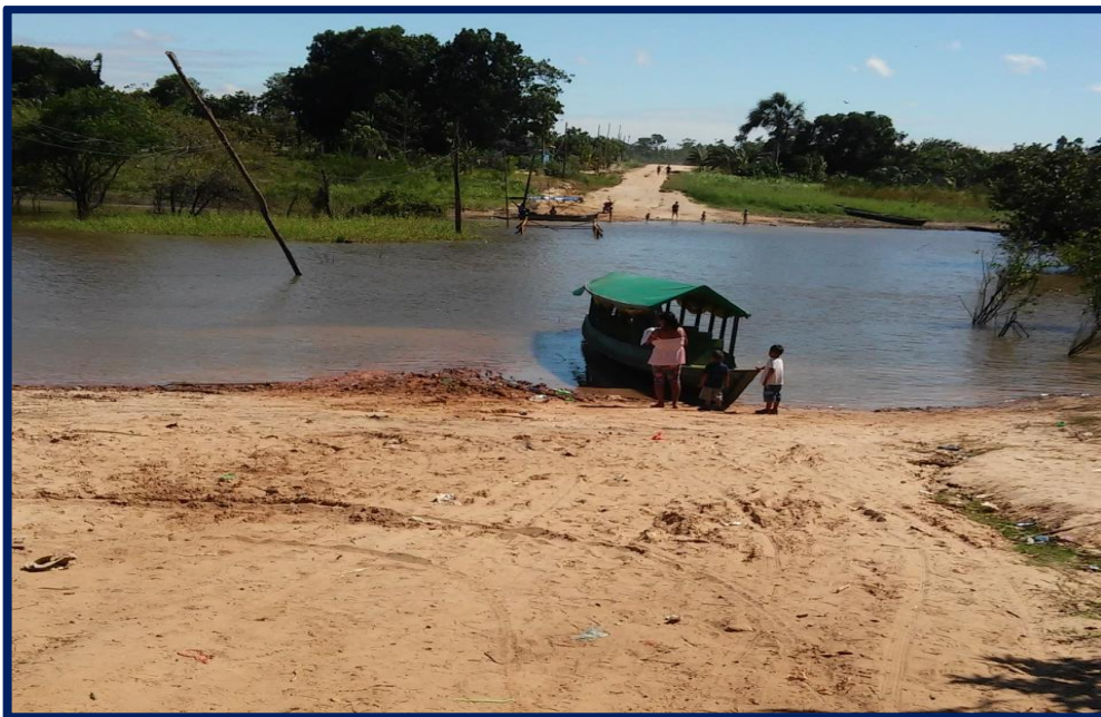
FOTO 08: SE OBSERVA LA DEFICIENTE FUNCION DEL PUENTE EXISTENTE EN EPOCAS DE CRECIENTE, POR LO CUAL SE PROYECTARA UN PUENTE DE C o A° 11.00 M. DE LONGITUD PARA AYUDAR EN LA TRANSITABILIDAD Y COMUNICACIÓN CON LA POBLACION DE LOS CASERIOS ALEDAÑOS.
