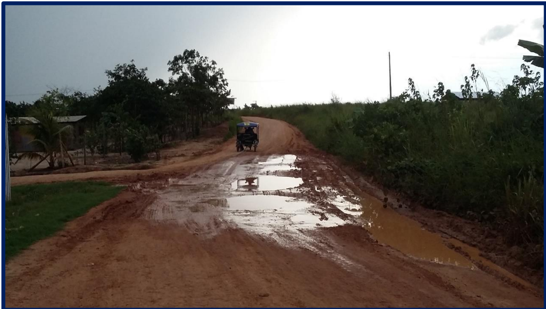
FOTO 12: SE OBSERVA EL DETERIORO DE LA VIA A MEJORAR, FALTA DE OBRA DE ARTE (ALCANTARILLADO), PARA UN ADECUADO DRENAJE PLUVIAL, SE OBSERVA LA FALTA DE ANCHO DE VIA CON UN ADECUADO AFIRMADO – PROGRESIVA 01+400.00
