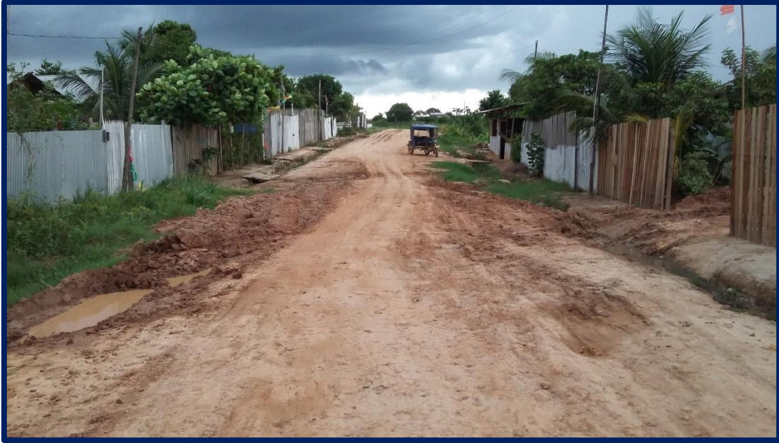
FOTO 13: SE OBSERVA EL DETERIORO DE LA VIA A MEJORAR, FALTA MEJORAR SISTEMA DE CUNETAS SIN REVESTIR, PARA UN ADECUADO DRENAJE PLUVIAL – PROGRESIVA 01+500.00
