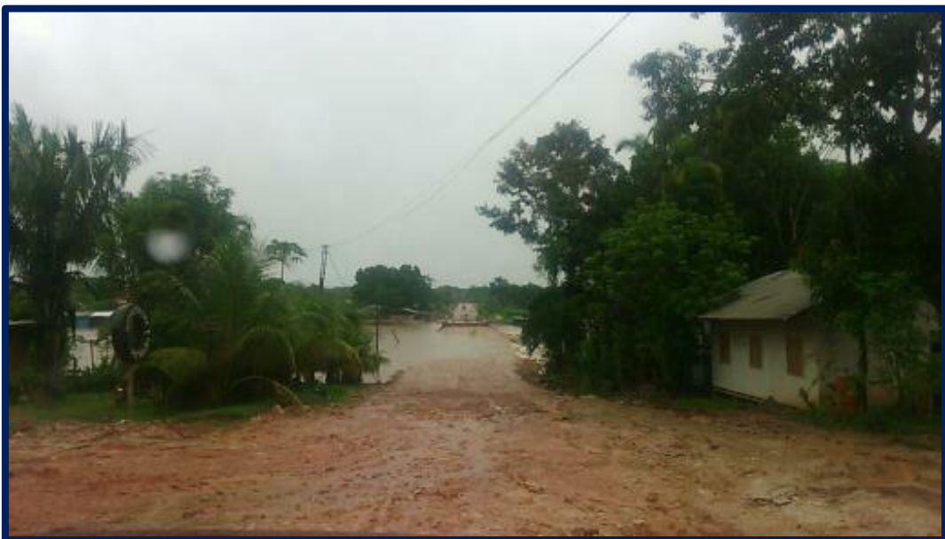
FOTO 05: TRAMO INICAL DE LA DEL MEJORAMIENTO DEL CAMINO VECINAL C.P. SAN JOSE – CASERIO SANTA ROSA – SE OBSERVA EL MAL ESTADO DE LA VIA, FALTA SISTEMA DE CUNETAS SIN REVESTIR PARA UN ADECUADO DRENAJE PLUVIAL - PROGRESIVA 00+200.00
