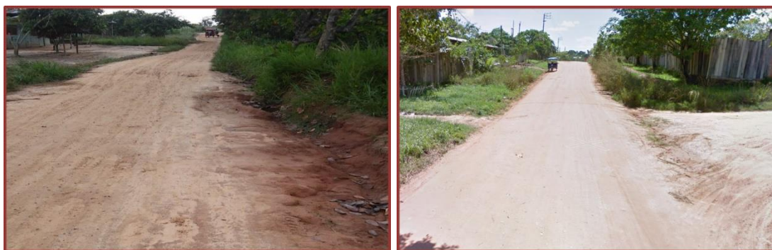
Fig. 2.2.2. Imágenes de la vegetación que hay sobre la vía y la inestabilidad de los taludes.
