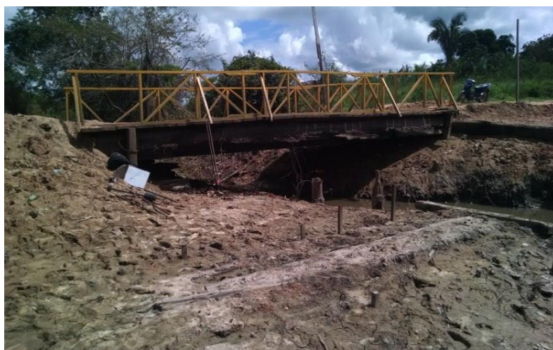
Fig. 2.3.1. Imágenes de las condiciones críticas en la que se encuentra la trocha carrozable y el puente artesanal.
