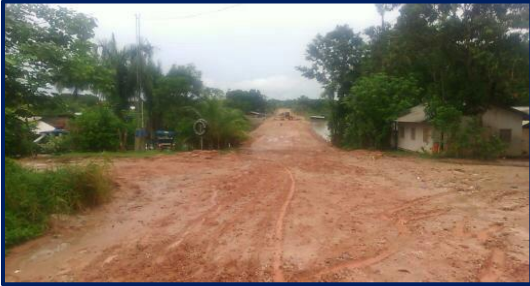
FOTO 04: TRAMO INICAL DE LA DEL MEJORAMIENTO DEL CAMINO VECINAL C.P. SAN JOSE – CASERIO SANTA ROSA – SE OBSERVA EL MAL ESTADO DE LA VIA, FALTA SISTEMA DE CUNETAS SIN REVESTIR PARA UN ADECUADO DRENAJE PLUVIAL - PROGRESIVA
