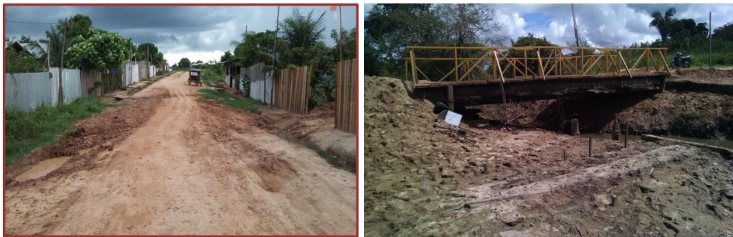
Fig. 2.2.1. Imágenes de la vegetación que hay sobre la vía y la inestabilidad de los
