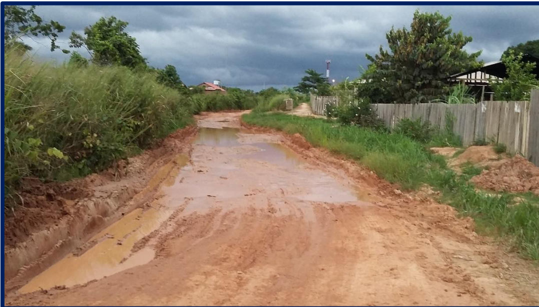
FOTO 10: CARRETERA AL CASERÍO SAN JUAN, SE OBSERVA EL MAL ESTADO DE LA VIA, LA FALTA DE SISTEMA DE DRENAJE OCASIONA EL DETERIORO DE LA VIA - PROGRESIVA 01+300.00
