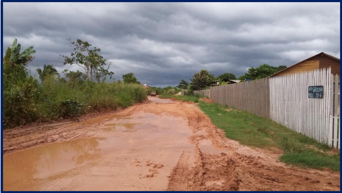
FOTO 11: SE OBSERVA EL DETERIORO DE LA VIA A MEJORAR, FALTA MEJORAR SISTEMA DE CUNETAS SIN REVESTIR, PARA UN ADECUADO DRENAJE PLUVIAL – PROGRESIVA 01+300.00
