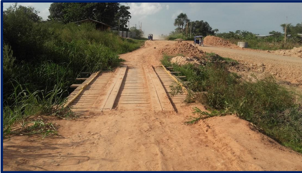
FOTO 05: SE OBSERVA EL PUENTE EXISTE A MEJORAR, DEBIDO QUE EN TIEMPOS DE INVIERNO LA CRECIENTE SOBREPASA EL NIVEL DE LA RASANTE DEL PUENTE – PROGRESIVA 00+406.00
