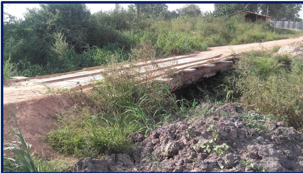
FOTO 06: SE OBSERVA LA DEFICIENTE FUNCION DEL PUENTE EXISTENTE, POR LO CUAL SE PROYECTARA UN PUENTE DE C°A° 11.00 M. DE LONGITUD PARA AYUDAR EN LA TRANSITABILIDAD A LA POBLACION.
