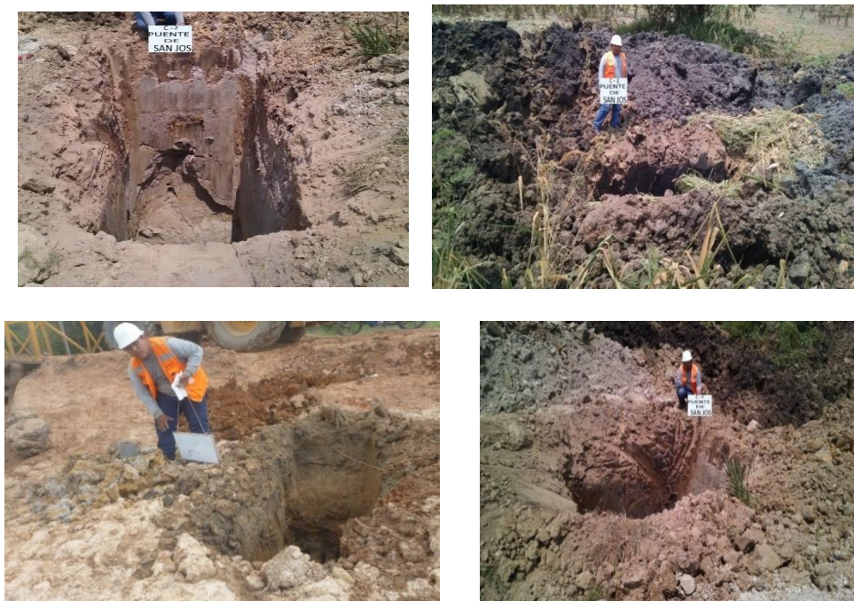
Fig. 5.1.6.4. Imágenes de las compactaciones de la subrasante en los tramos y del puente.
