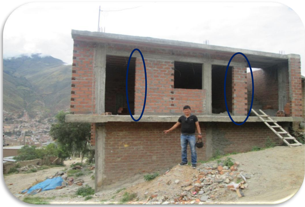
FOTOGRAFÍA 13. Se observa la discontinuidad y la falta de confinamiento de los muros en el 2do nivel de la vivienda.
