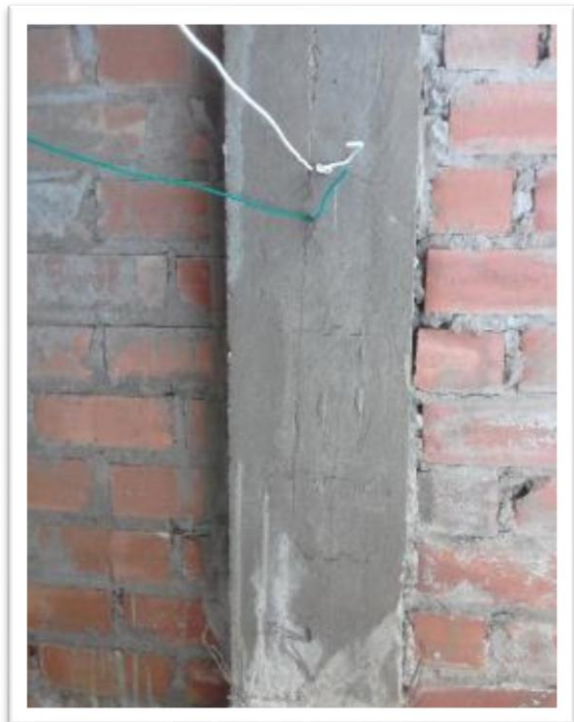
Fisuras en columnas y juntas
