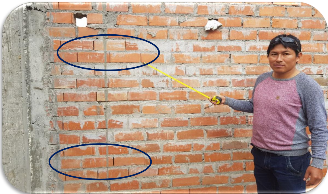
FOTOGRAFÍA 04. Se observa la ausencia del mortero en algunas hiladas disminuyendo la adherencia con las unidades de albañilería donde posteriormente se generan grietas.
