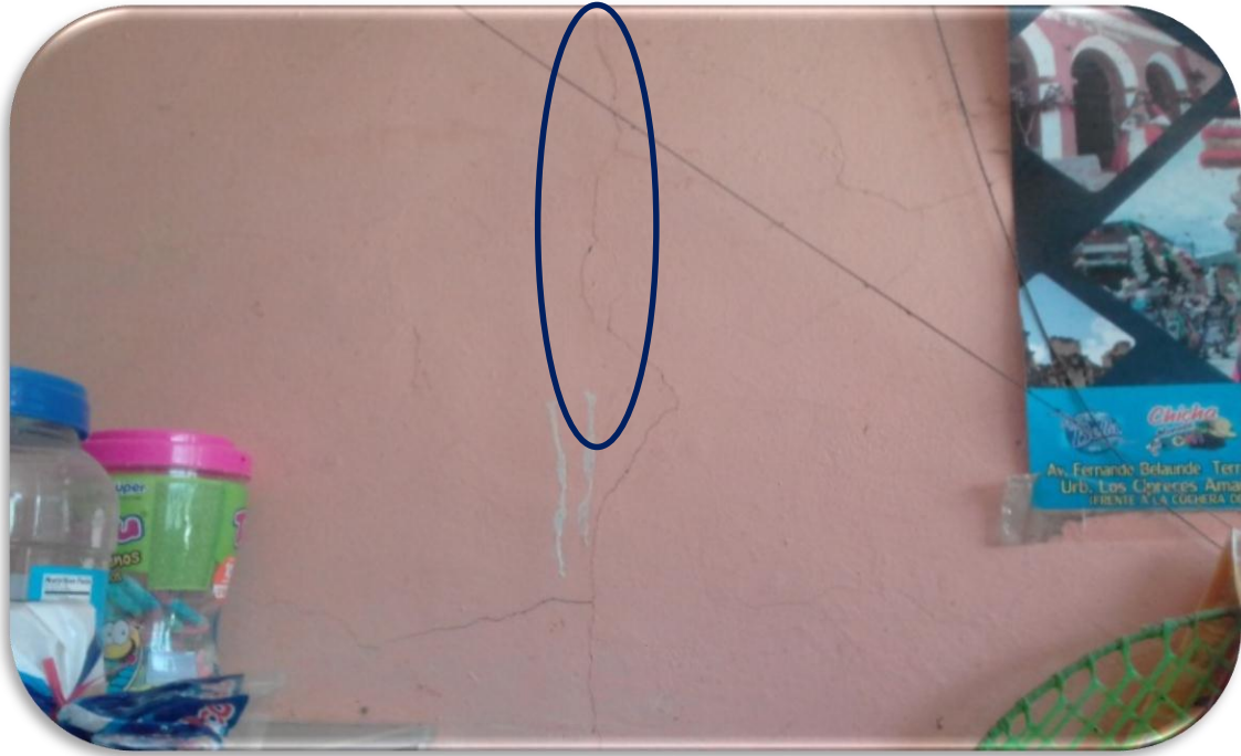
FOTOGRAFÍA 07. Se observa fisuras en las paredes debido a la baja calidad de la dosificación de la mezcla para los acabados (tarrajeo).
