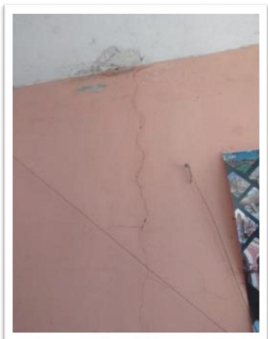
Fisuras en muros de albañileria
