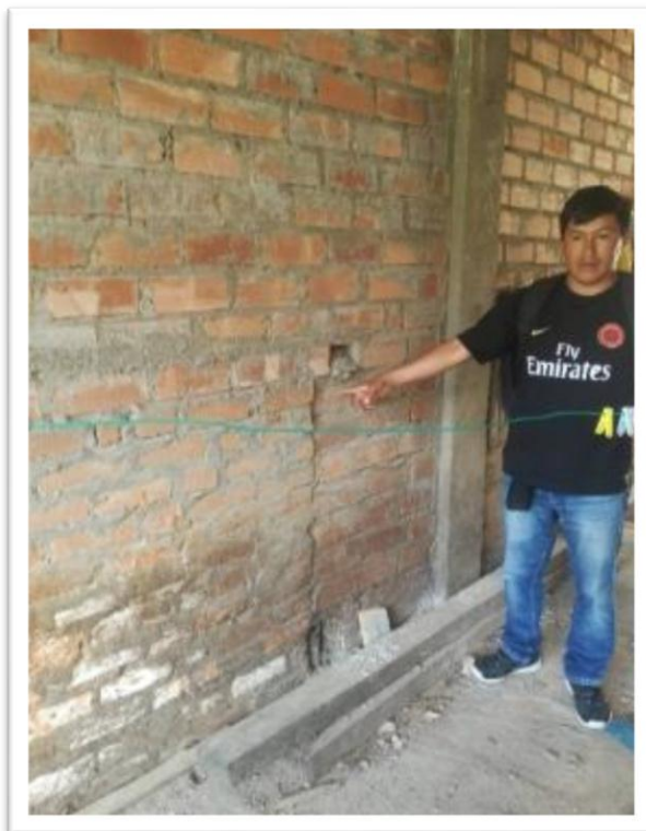
Deficiente traslape de ladrillos
