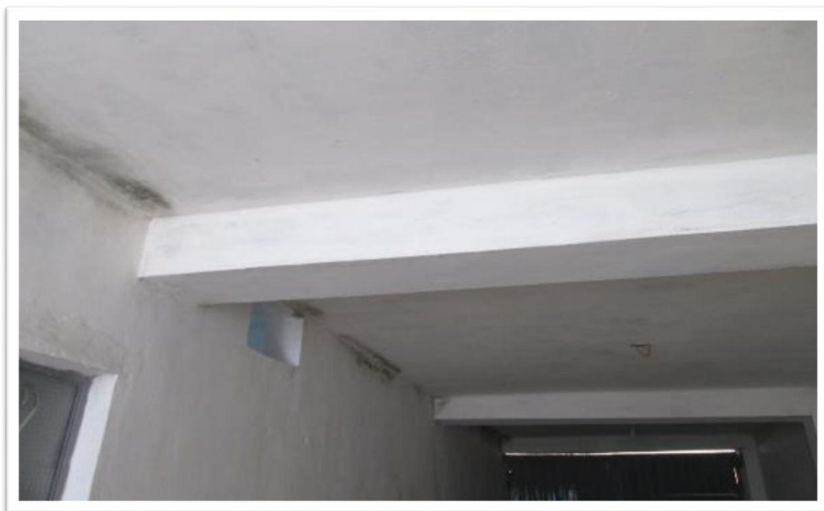
Inadecuado apoyo de las vigas peraltadas
