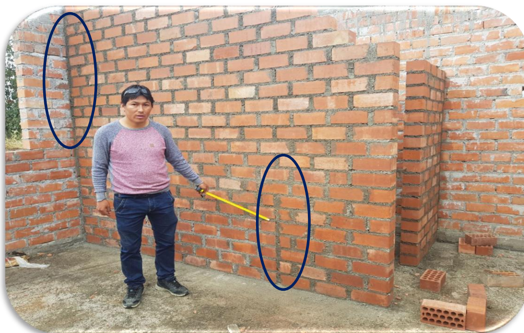
FOTOGRAFÍA 06. Se observa la inadecuada distribución de ladrillos sin traslapes ni confinamiento en los bordes y esquinas, expuestos a caer en bloque ante un movimiento sísmico.
