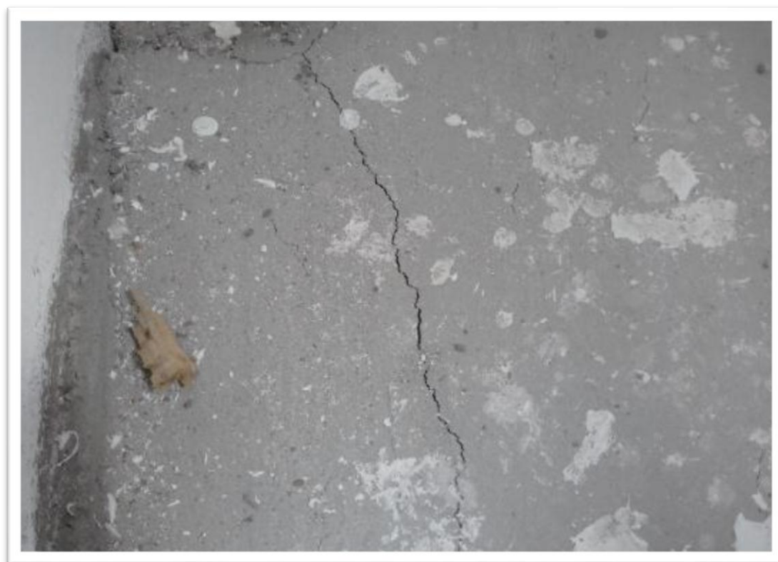
Fisuras en el falso piso de la vivienda
