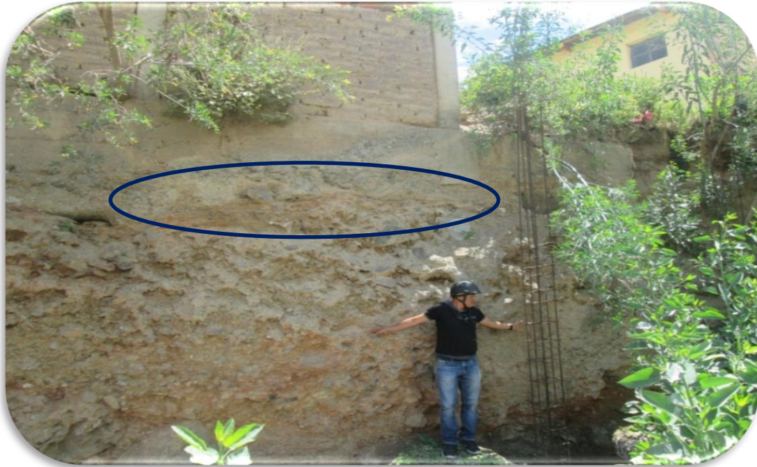
FOTOGRAFÍA 15. Se observa la cimentación expuesta por completo debido al corte que realiza la construcción vecina.
