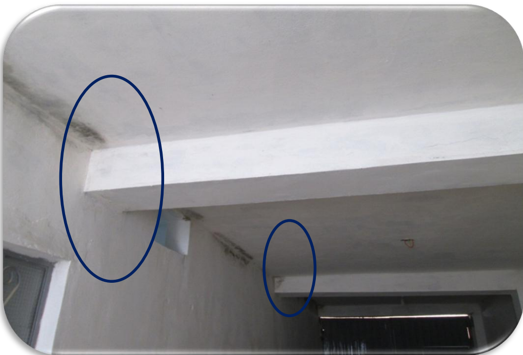
FOTOGRAFÍA 14. Se observa el apoyo de las vigas peraltadas sobre muros de albañilería generando inestabilidad ante un evento sísmico.
