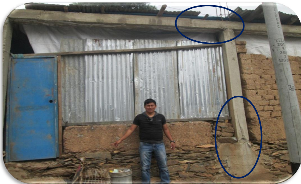
FOTOGRAFÍA 10. Se observa la cimentación de la columna expuesto a la intemperie y de baja calidad, las vigas no tendrán una adecuada adherencia al realizar el llenado de la losa aligerada.
