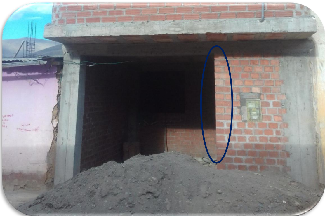
FOTOGRAFÍA 08. Se observa muros sin confinamiento en esquinas que generan inestabilidad ante un movimiento sísmico.
