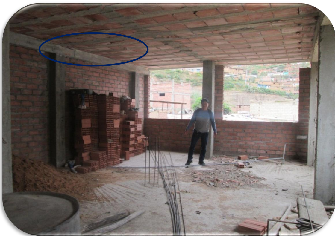
FOTOGRAFÍA 11. Se observa la inexistencia de la viga entre las columnas generando inestabilidad y deformación de la losa aligerada.
