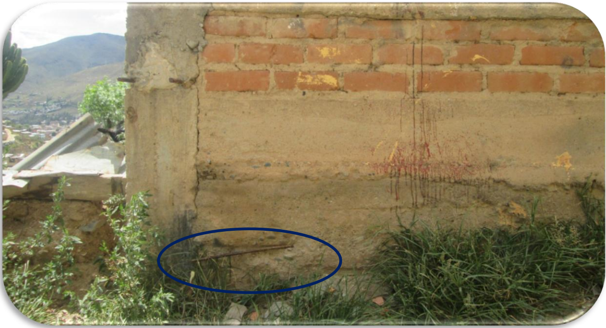
FOTOGRAFÍA 03. Se observa los aceros de la cimentación expuestos a la intemperie disminuyendo su resistencia debido a la corrosión.
