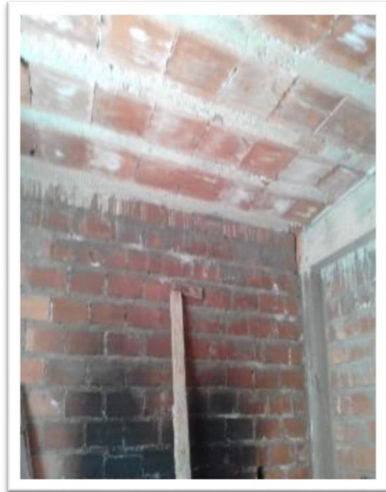
Inexistencia de las vigas de amarre
