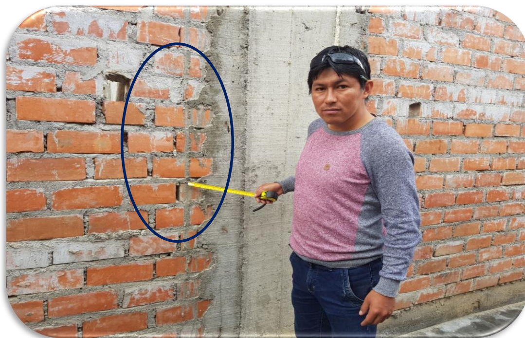
FOTOGRAFÍA 05. Se observa el mortero de baja calidad, de espesor variable menor a 0.5 y mayor a 2cm por lo que presenta hiladas desordenadas poco uniformes.
